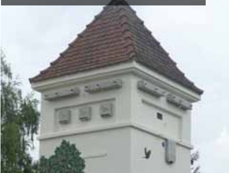
Einlaufblenden und Fassadenquartiere für Fledermäuse an der Trafostation
